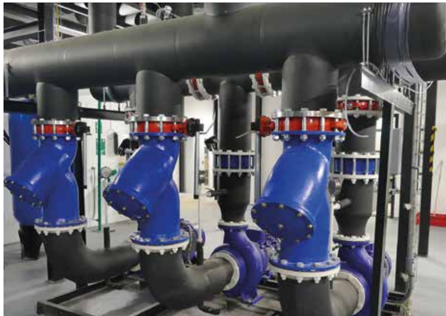
Bombas de etilenglicol líquido para sistemas de refrigeración de amoníaco verde.
